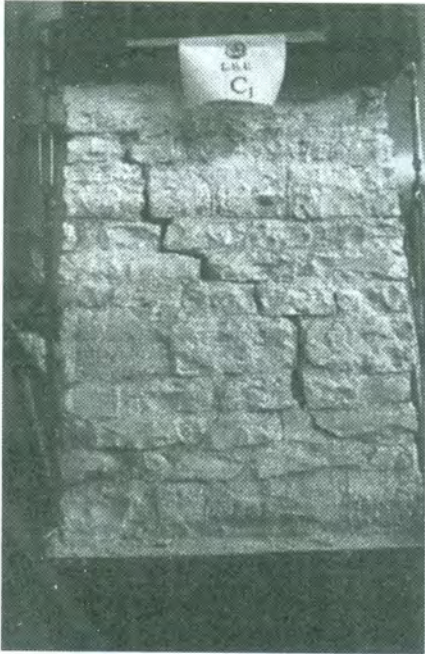
Σχήμα 8. Ρηγματωμένο δοκίμιο C1 Figure 8. Crack pattern of specimen C1
