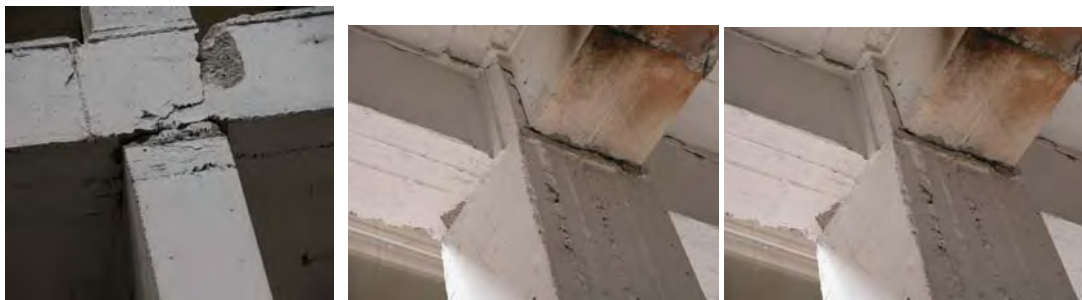
Σχήμα 8. Δοκίμιο Δ1-R1-BFR: Αστοχία κόμβων δοκών - υποστυλωμάτων.
