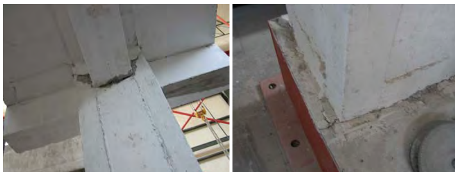
Σχήμα 12. Δοκίμιο Δ5-T2-MANA: Αστοχία σε κόμβο δοκού- υποστυλώματος και πόδα υποστυλώματος ισογείου.
