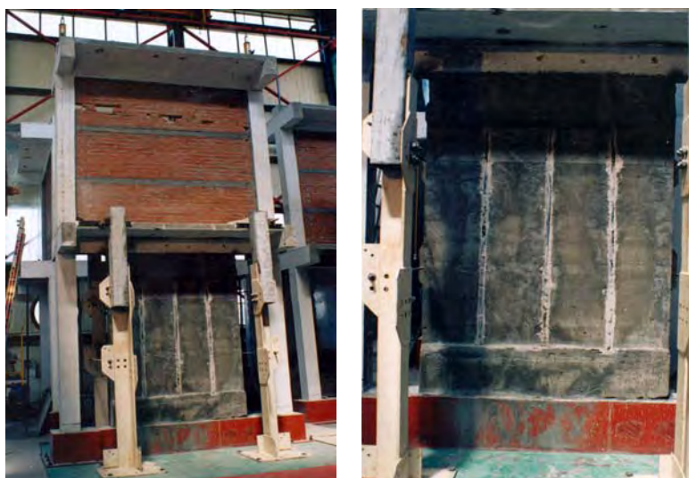
Σχήμα 13. Δοκίμιο Δ6- T3- MMRCWA: Αστοχία τοιχοπλήρωσης ορόφου, οριζόντια ρωγμή στη βάση του τοιχείου
