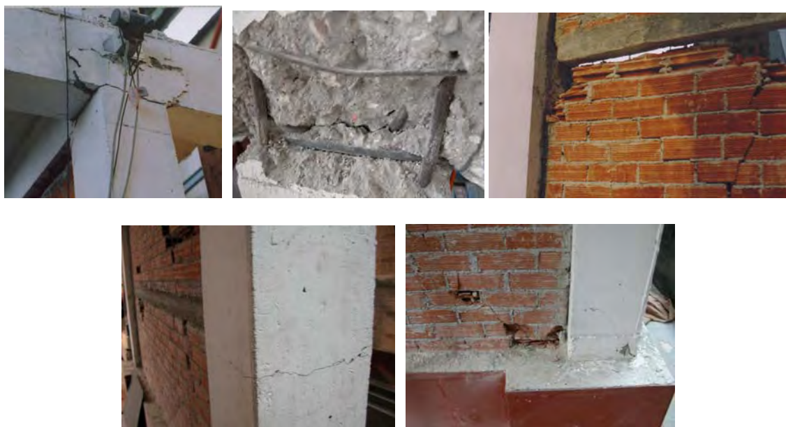
Σχήμα 9. Δοκίμιο Δ2-R2-BWBA: Αστοχία δοκιμίου μετά το πέρας των δοκιμών.
