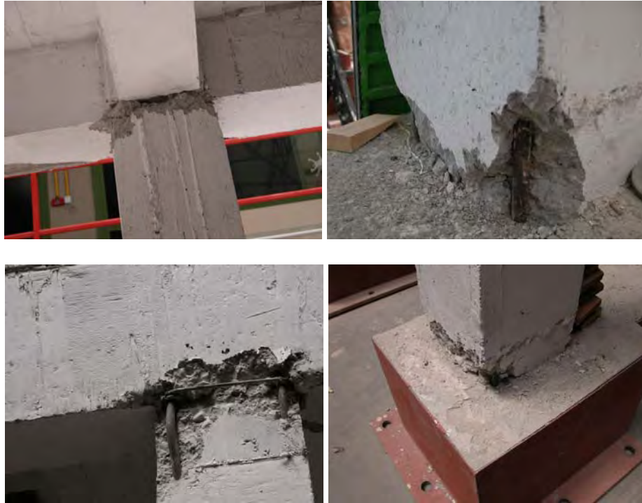
Σχήμα 10. Δοκίμιο Δ3-R3-BWB: Αστοχία δοκιμίου μετά το πέρας των δοκιμών.
